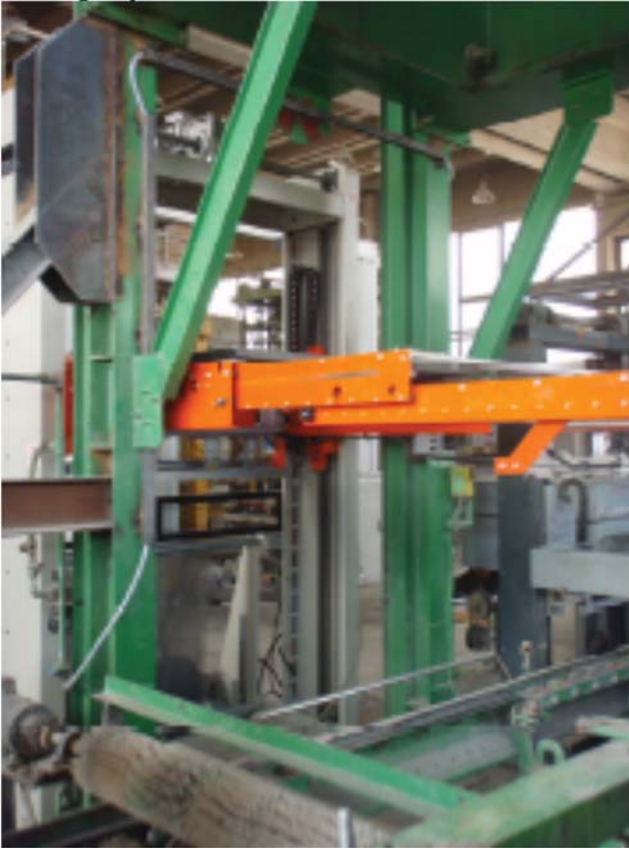
Netzaufleger eingebaut in Palettierer
